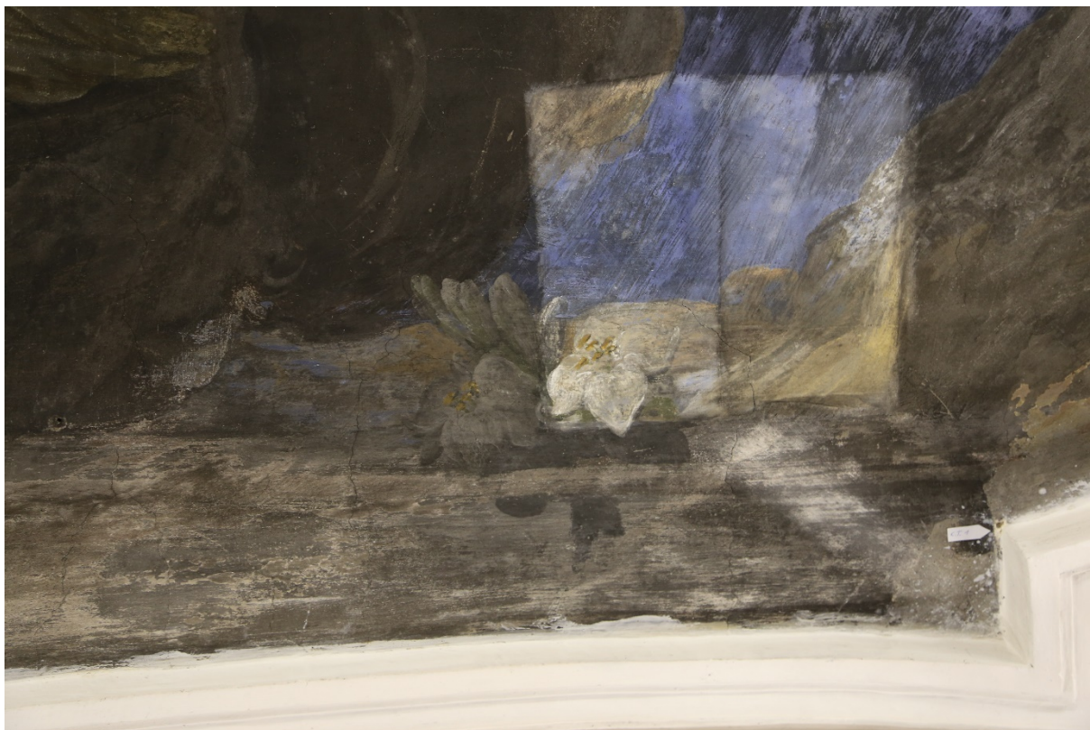
Odkrywka z brudu wykonana metodami mechanicznymi i chemicznymi. Widoczne trudne do usunięcia pozostałości brudu, utrwalonego prawdopodobnie środkiem impregnującym.
